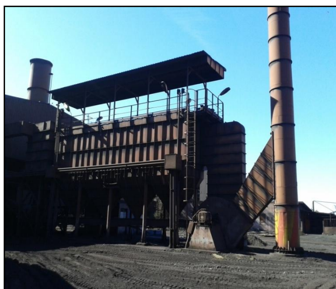
Vue générale du dépoussiéreurs
