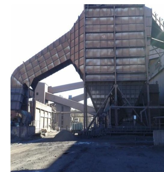
Vue générale du dépoussiéreurs
